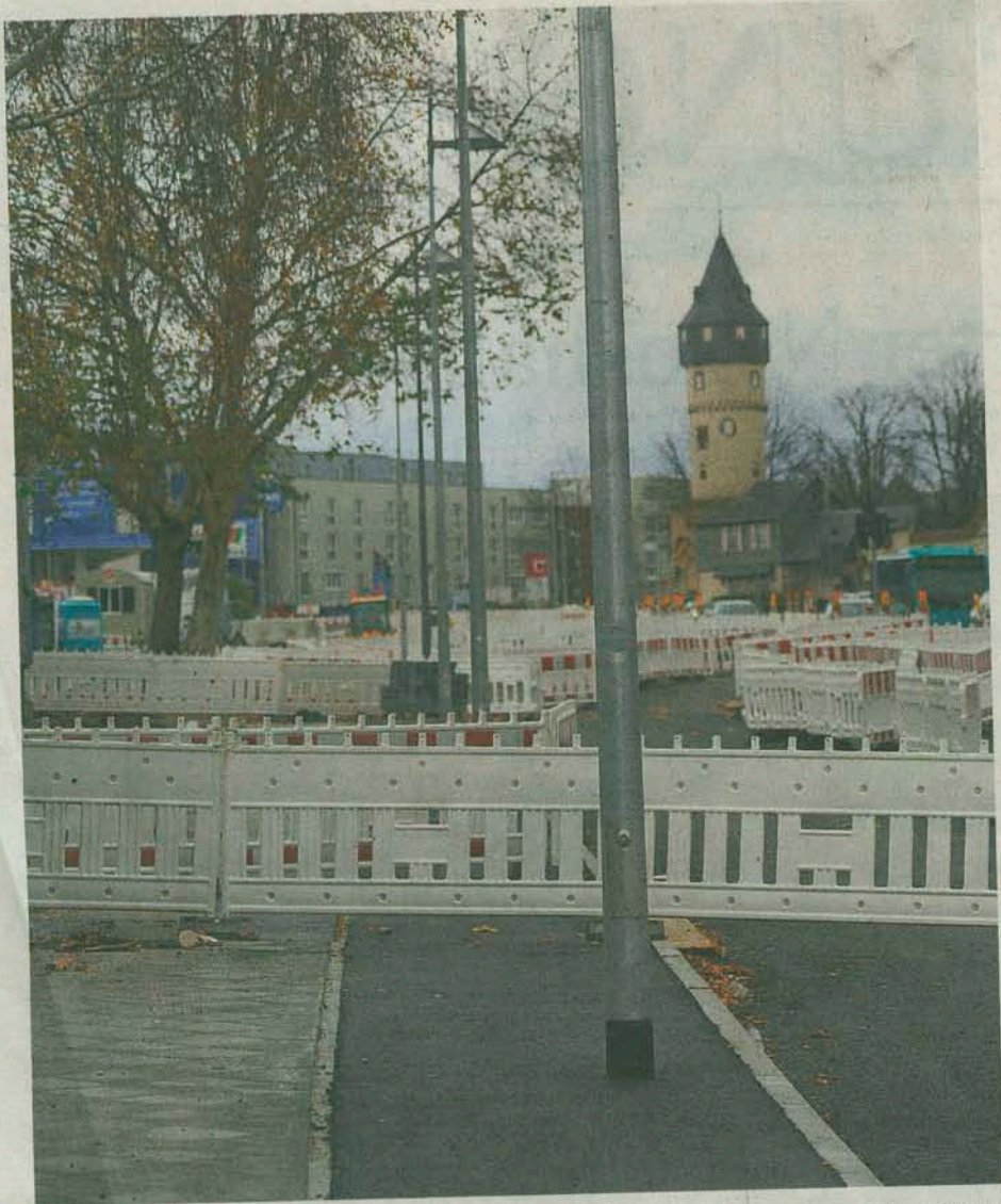
Gefährlich: Ein Laternenmast mitten auf dem Radweg
